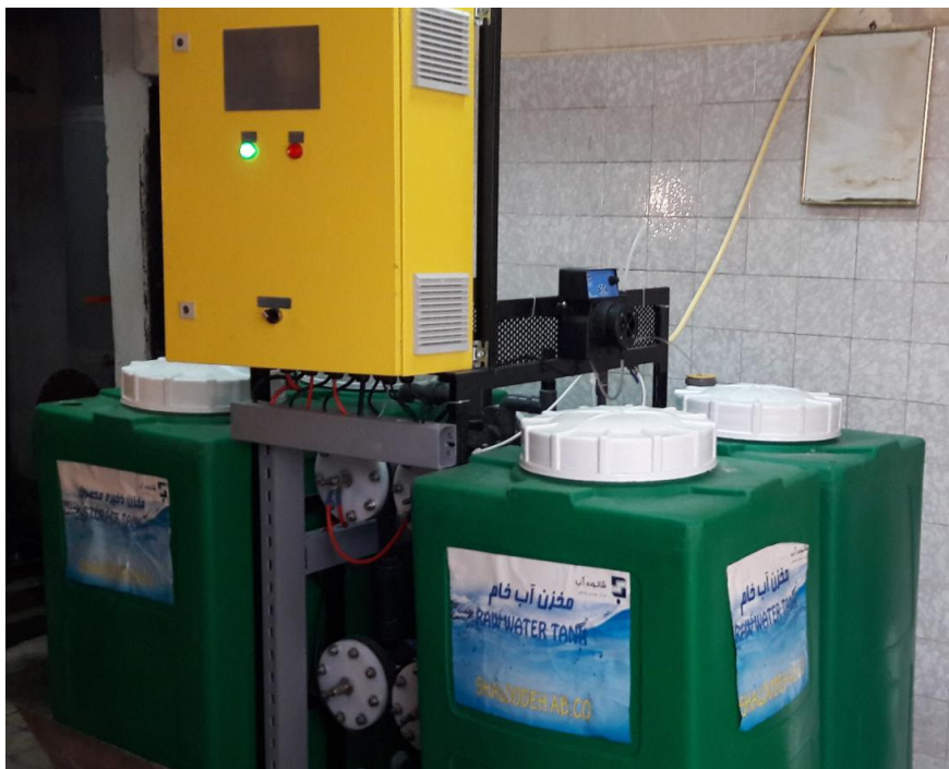
شکل ۱۴- دستگاه تصفیه نمک نصب شده در استخر بجای کلرزنی
