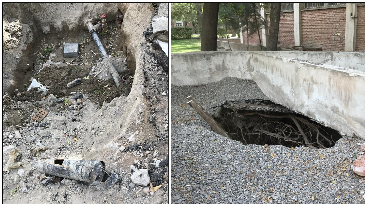
شکل ۴-۴- نشست زمین در اثر ترکیدن لوله آب، نمونه‌ای از خرابی‌های مکرر در شبکه مورد مطالعه (آذر ۱۳۹۷، جنب آزمایشگاه خاک دانشگاه تبریز)
